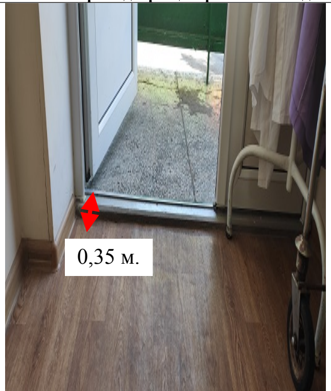
Фото №26 высота порога двери центрального входа
